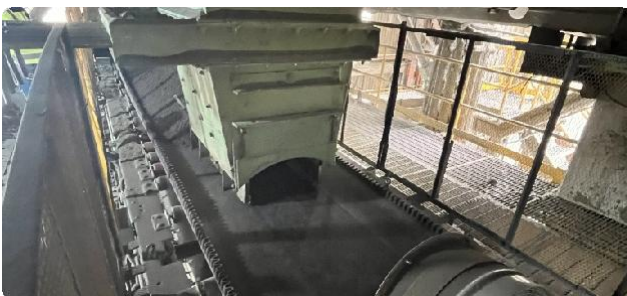
Punto de alimentación del dosificador de clínker
